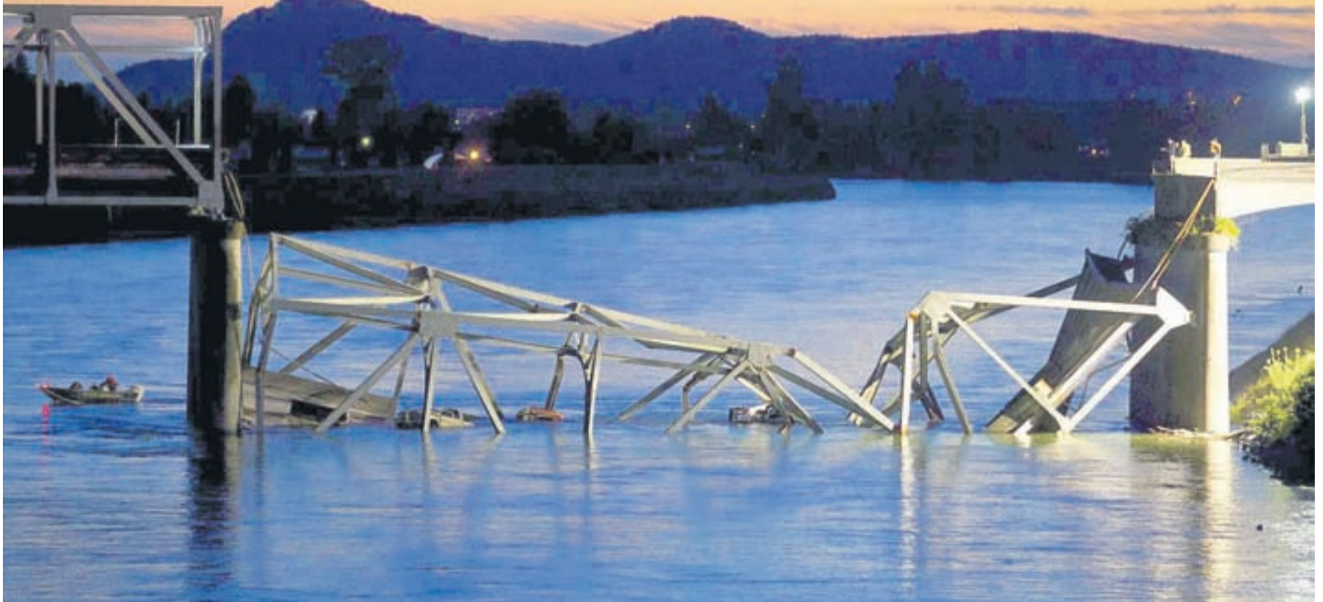
E colapso di e Interstate 5.
